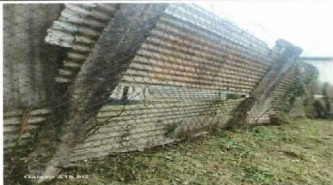
Foto 1: El muro perimetral requiere mantenimiento
