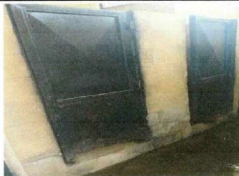
Foto 4: Se observa deterioro en los sanitario a la cual requiere rehabilitacion
