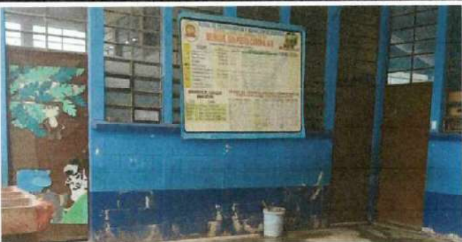
Foto 5: Las puertas del modulo 1 requiere mantenimiento
