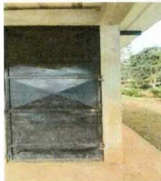
Foto 2: Se observa deterioro de la puerta del modulo No. 1
